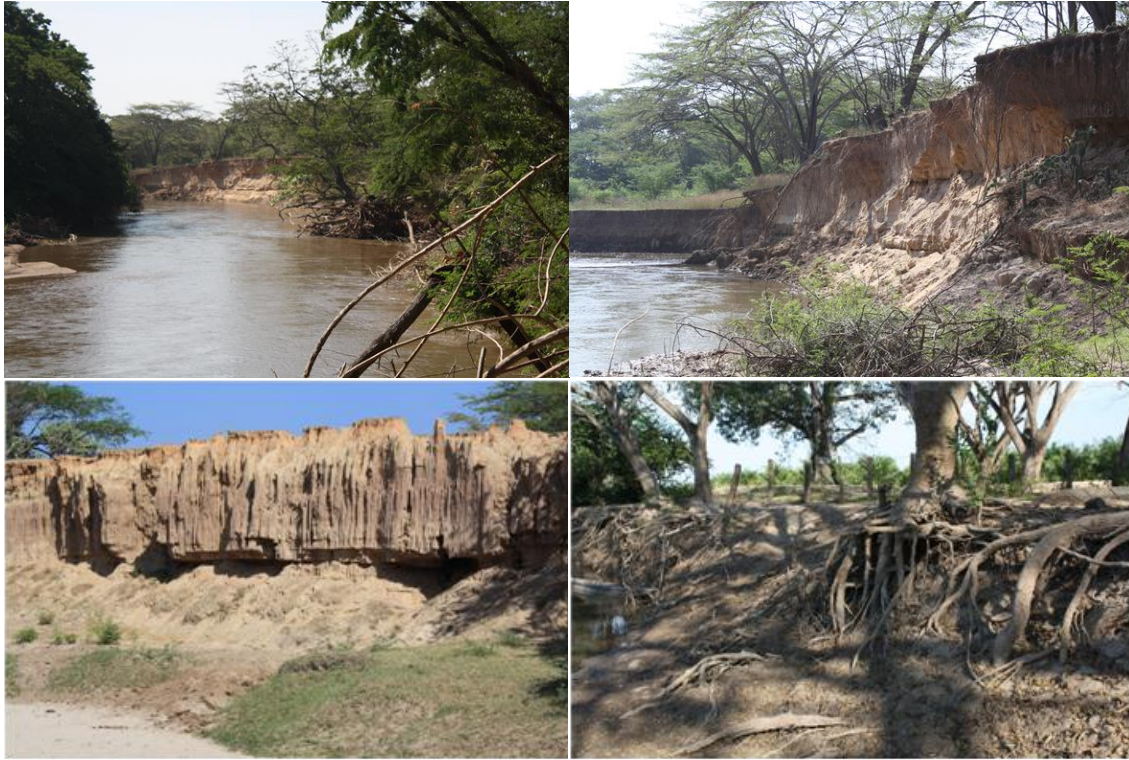
Figura 3. Problemas de infraestructura ubicada sobre las riberas del río Cesar.
