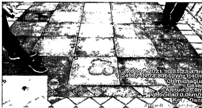
Imagen No. 4. Estado de deterioro del piso existente del muelle. Fuente Propia.
