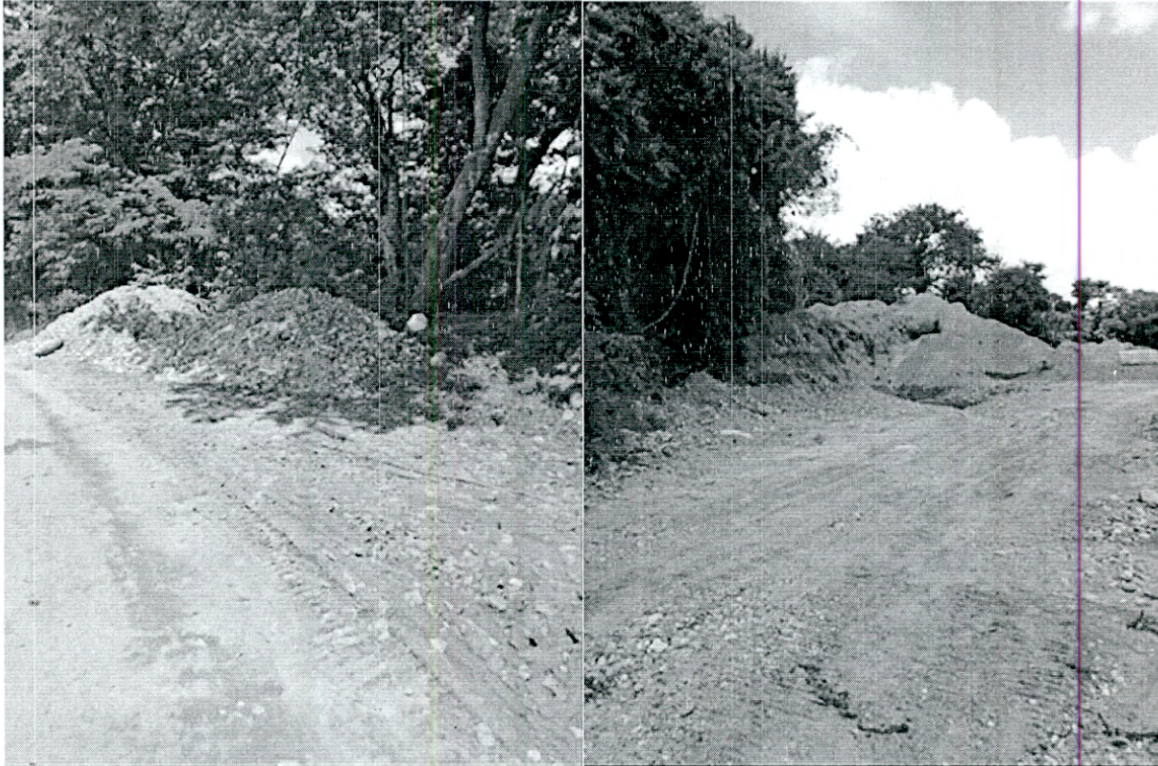
Fotografía 6. Acopio inadecuado de material en diferentes partes del frente de explotación mecanizado.
