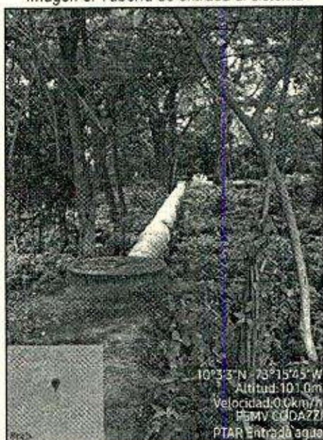
Imagen 3. Tubería de entrada al sistema
