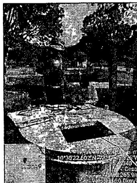
Ilustración 2: Punto de captación (pozo La Vieja Carmen) Fuente: Corpocesar 2022
