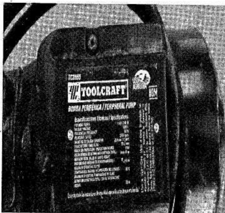
Foto 3. Detalle equipo de bombeo aljibe No. 1
