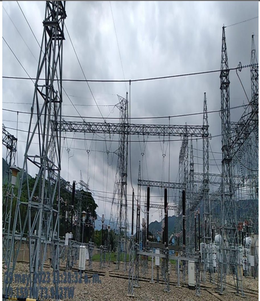
Subestación El Copey
