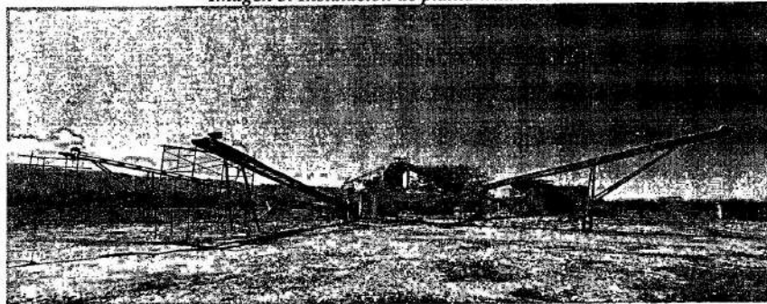
Imagen 3. Instalación de planta trituradora
