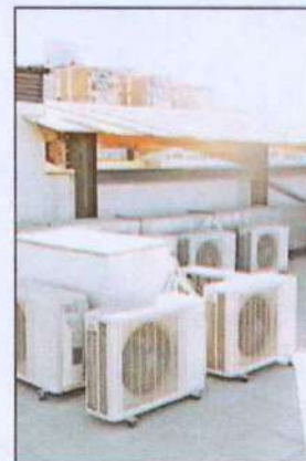
HOY EN día los sistemas HVAC en los edificios no solo son los responsables del aumento en los costos de energía, sino que el uso que le dan a productos químicos, un destructor de la capa de ozono.
