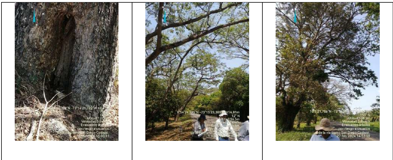
Arriba, los registros fotográficos muestran a los diferentes árboles invadiendo la parte aérea del área de rodamiento, los cuales están propensos a colapsar, sea parte del árbol o todo debido a la inestabilidad mecánica de la estructura y por la fuerza aerodinámica del viento.
