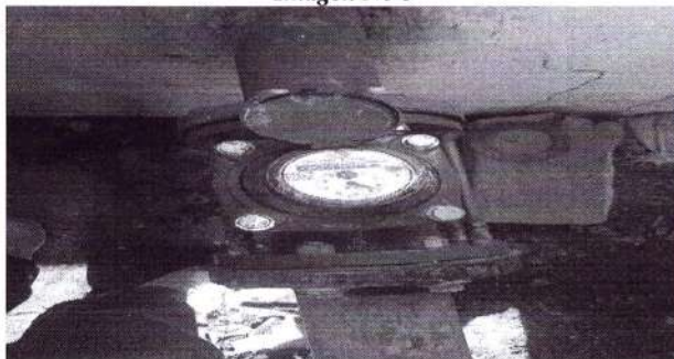
Macromedidor de Caudal Instalado.
