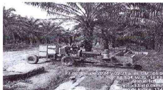
Foto 2. Detalle equipo de bombeo pozo 27A
