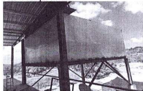
Foto 9. Tanque del almacenamiento proceso de fundición
