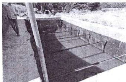
Foto 11. Tanque de enfriamiento
