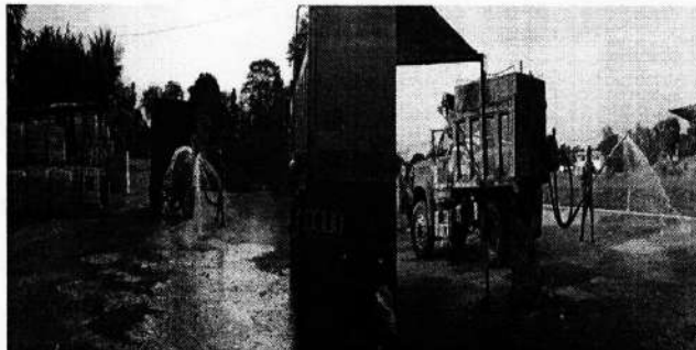
Imagen. Sistema de riego de agua mediante flautas perforadas instaladas en carrotanques – riego de vía de entrada y vías interna del proyecto.
