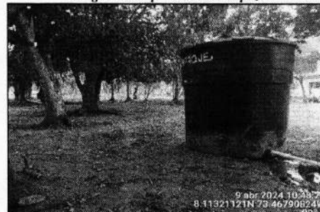
Imagen 4. Tanque conectado al pozo
