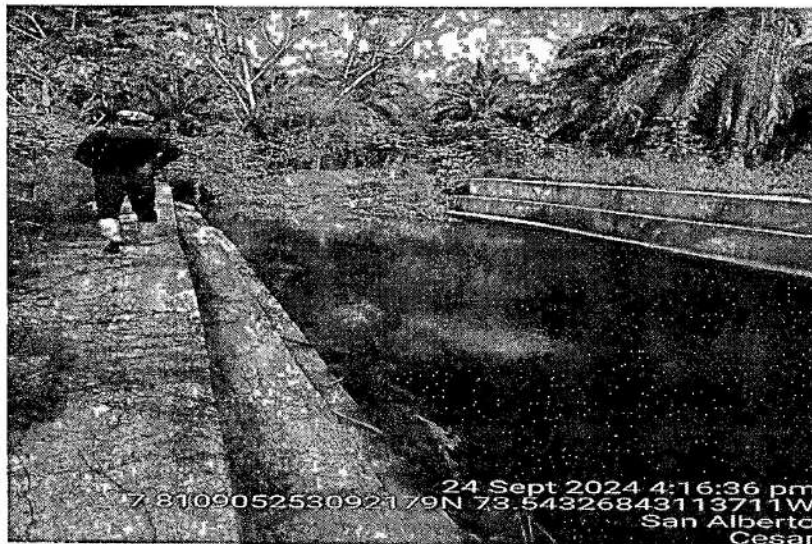
Ilustración 2. Situación de tuberías Oleoducto Ayacucho Galán 8 en cruce subfluvial microcuena NN1.
