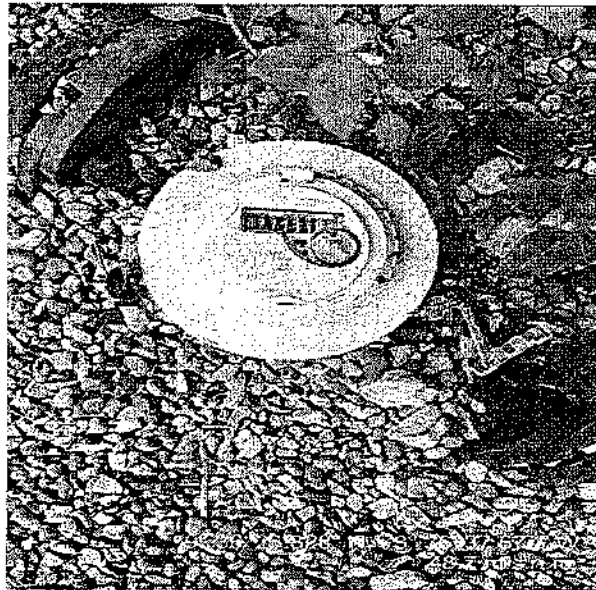
Foto No 9. Medidor de Caudal
