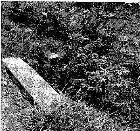
Imagen No. 14: Condiciones en las que se encuentra la alcantarilla "ALC10". Fuente Propia.
