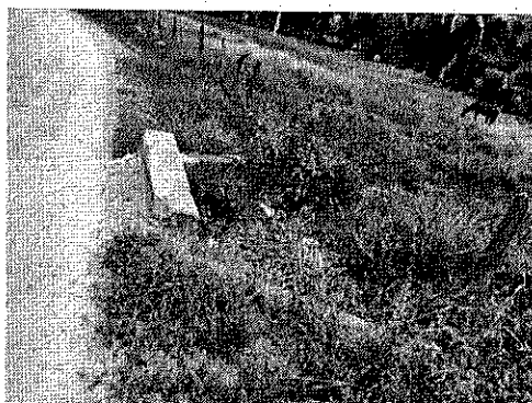
Imagen No. 5: Condiciones en las que se encuentra la alcantarilla "ALC02". Fuente Propia.
