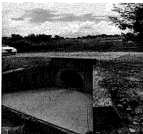
Imagen No. 8: Condiciones en las que se encuentra la alcantarilla "ALC05". Fuente Propia
