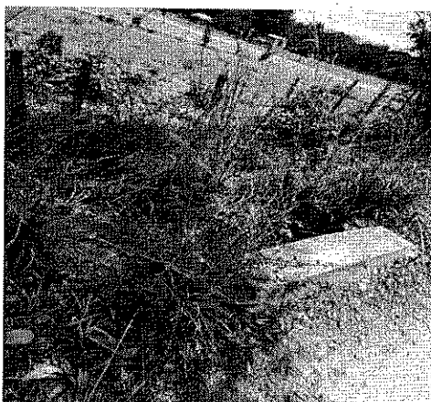
Imagen No. 9: Condiciones en las que se encuentra la alcantarilla "ALC06". Fuente Propia
