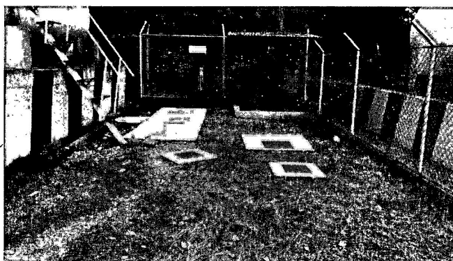
Ilustración 5. Vista Sistema de Tratamiento de Aguas Residuales no Domesticas (ARnD)
