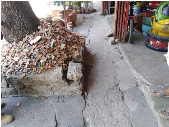
Foto 7. Detalle Fracturas andén locales comerciales
