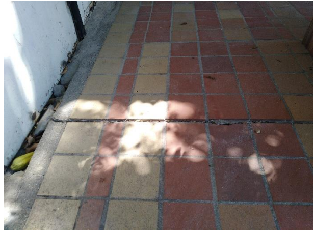
Foto 6. Detalle del fracturamiento del andén casa parroquial
