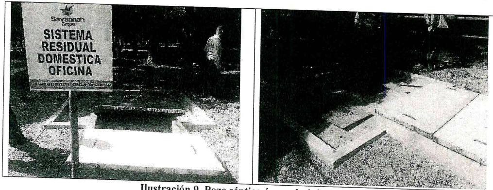
Ilustración 9. Pozo séptico área administrativa.
