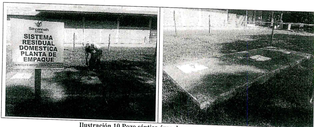
Ilustración 10 Pozo séptico área de empaque y bodega
