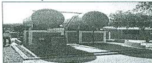
Foto 9. Tanques de almacenamiento combustible.
