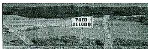
Foto 18. Sistema de pozos de sedimentación.
