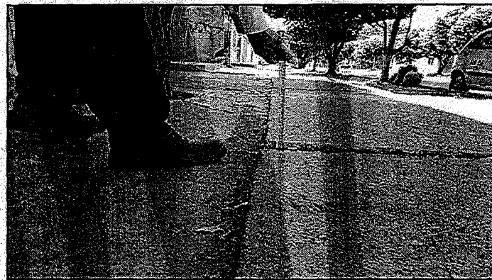
Fig. 12 Daño a obras públicas con las raíces (andén levantado).
