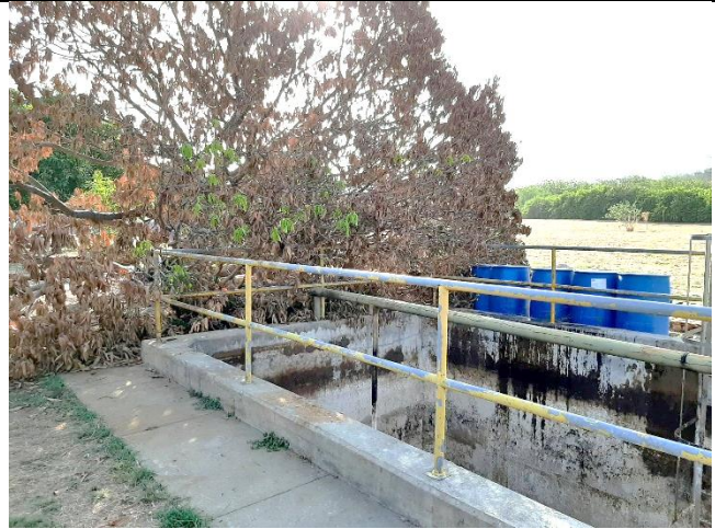
Imagen 2. Arbol de Mango tumbado sobre la unidad de tratamiento de aguas residuales de la compañía DPA."
