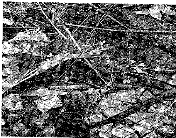
Imagen No. 7: Condiciones en las que se encontró la del Caño León. Fuente Propia.
