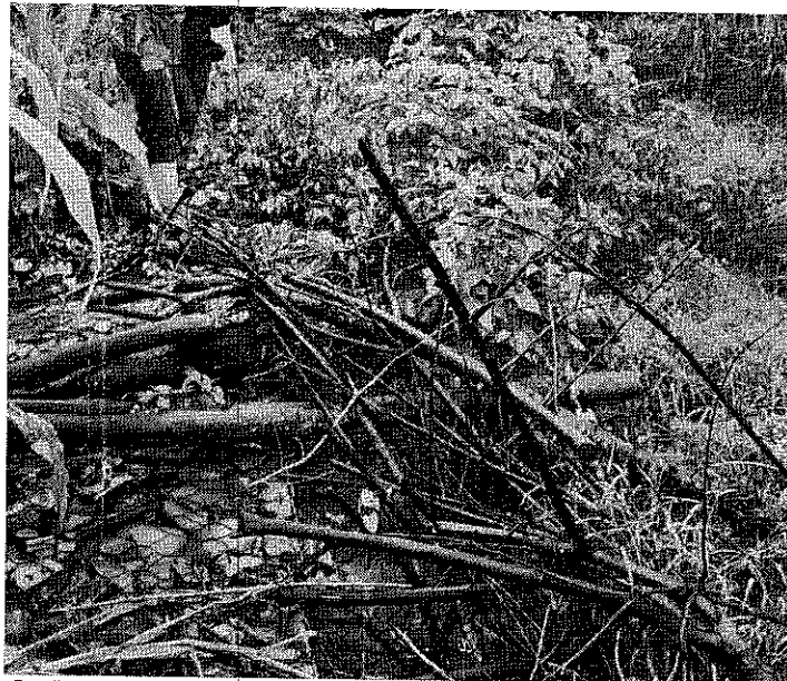
Imagen No. 5: Condiciones en las que se encontró el muro en gavión dentro del cauce del Caño León. Fuente Propia.
