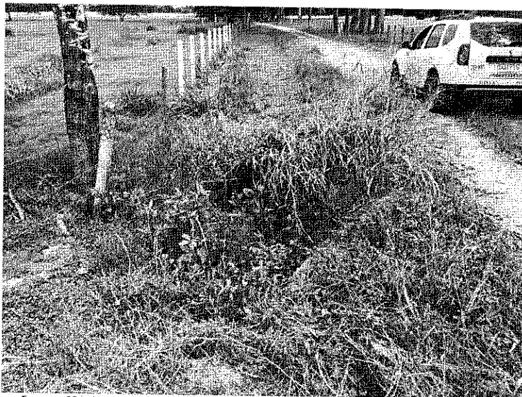
Imagen No. 13: Condiciones en las que se encuentra la alcantarilla "ALC06 - OC04A". Fuente Propia.
