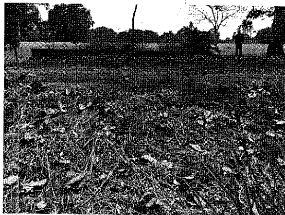
Imagen No. 12: Condiciones en las que se encuentra la alcantarilla "ALC05 - OC04". Fuente Propia.
