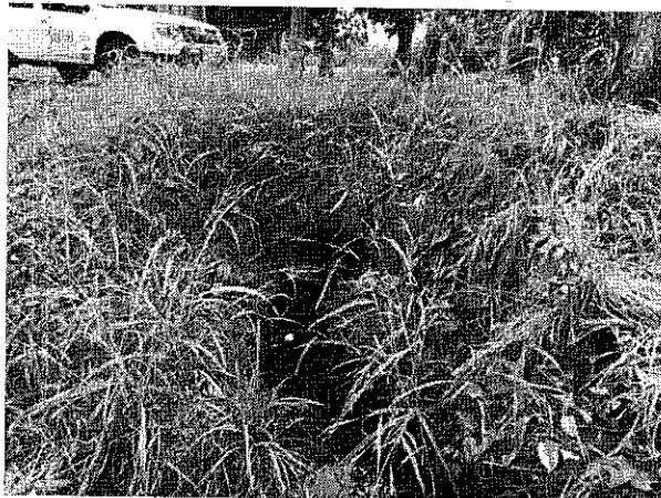
Imagen No. 11: Condiciones en las que se encuentra la alcantarilla "ALC04 - OC03". Fuente Propia.
