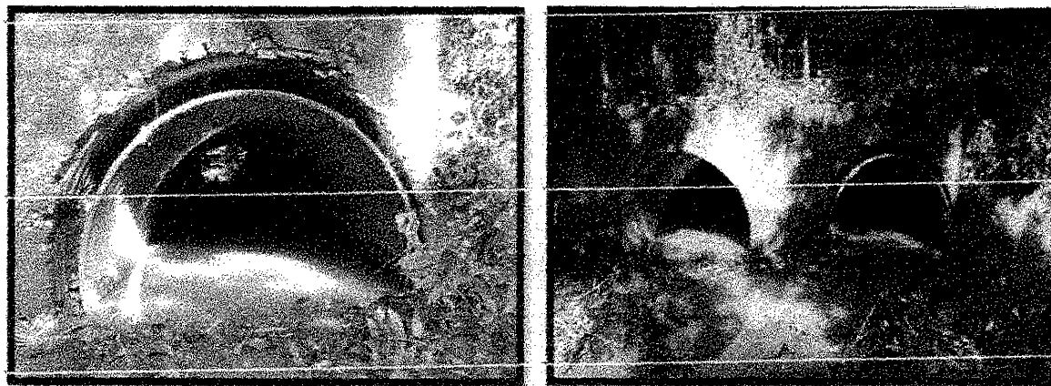
Alcantarillas colapsadas de la obra hidráulica existente PK602+540.
