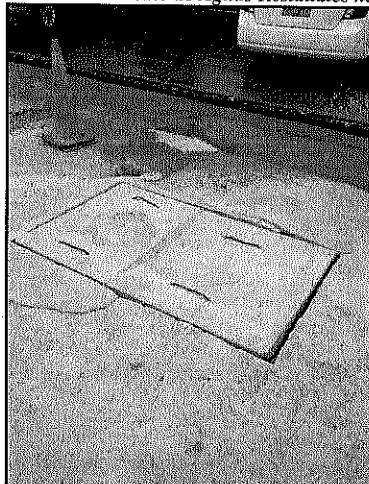
Imagen 4. Vista Sistema de Tratamiento de Aguas Residuales no Domésticas (ARnD)
