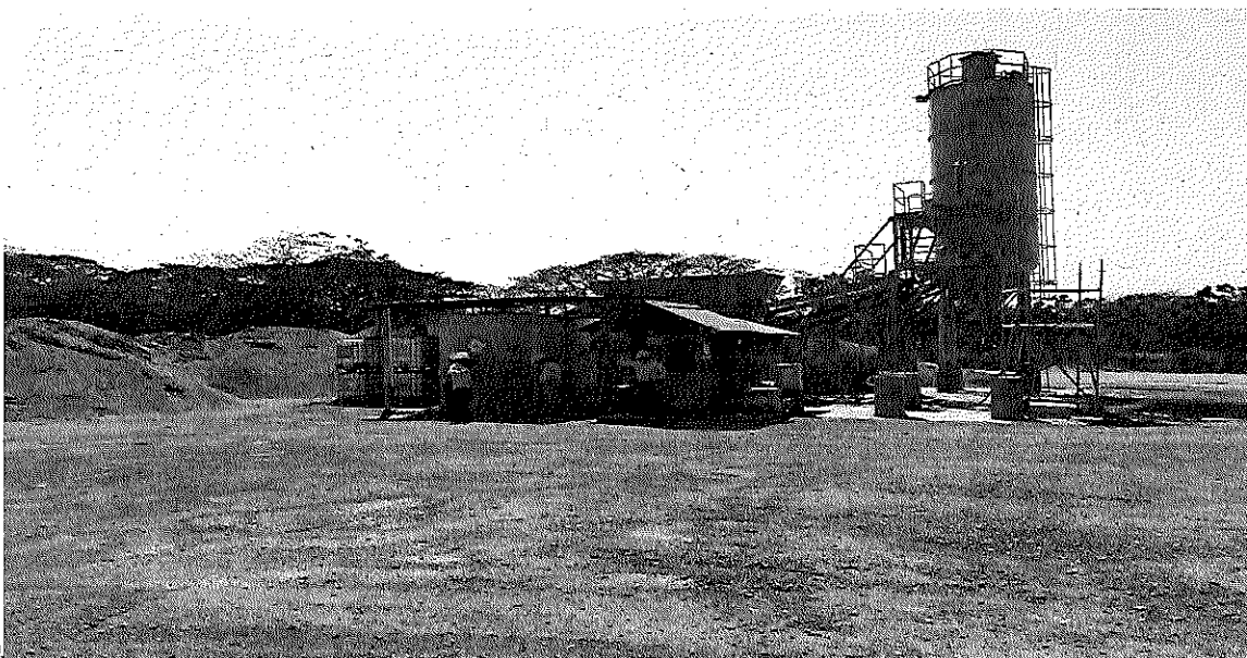
Foto 11. Planta dosificadora de concreto
