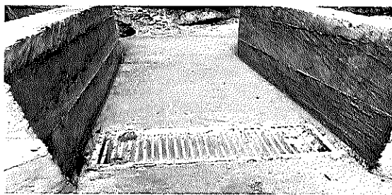
Foto 4. Detalle de la rejilla de captación
