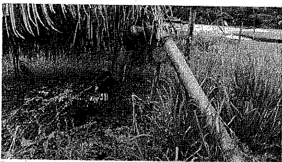
Imagen 1. Punto de succión de las aguas del reservorio.
