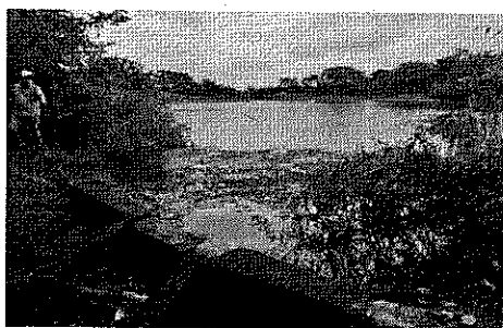
Imagen 16. Vertedero de excesos No. 2
