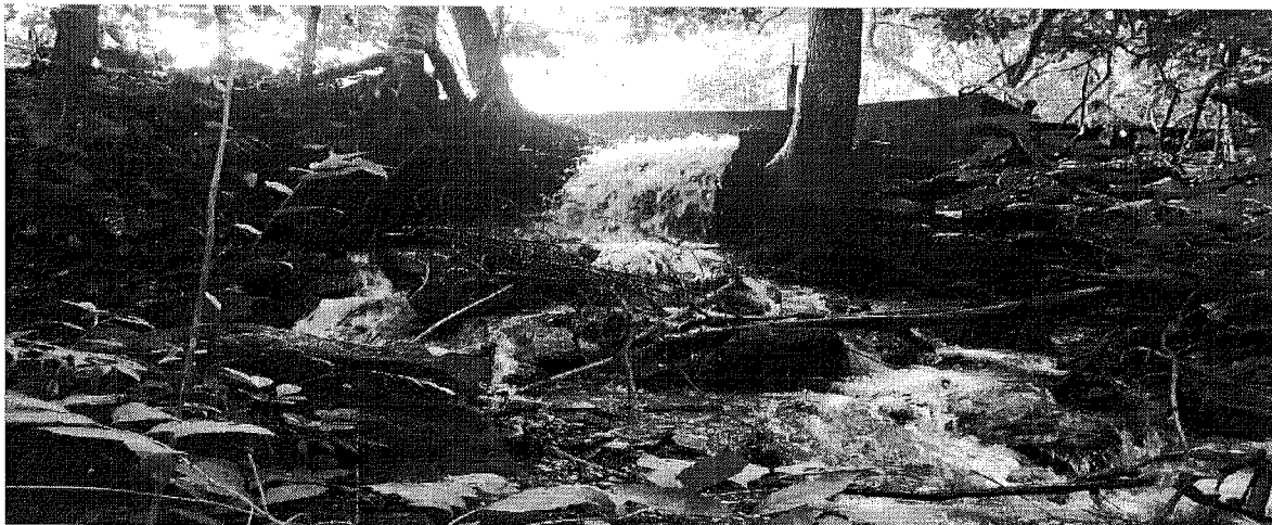
Fotografía 11: Descole de la tubería de 8" hacia la quebrada Buturama.
