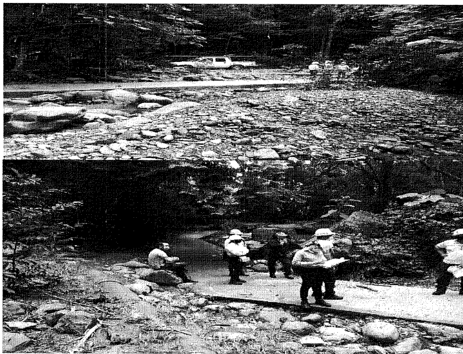
Fotografía 16: Proceso de socavación presentado en la línea de conducción entre desarenadores.
