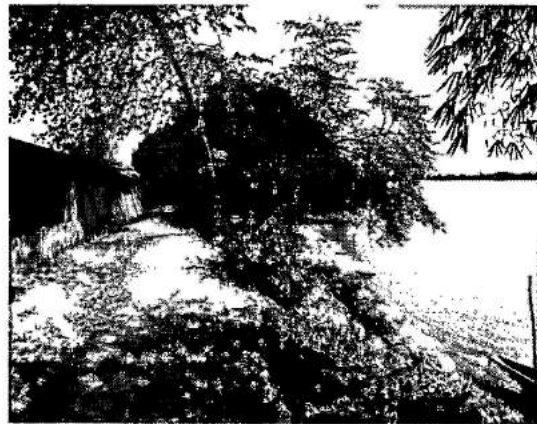
Imagen No. 8: Condiciones actuales en las que se encuentra el Dique "El Contento". Fuente propia
