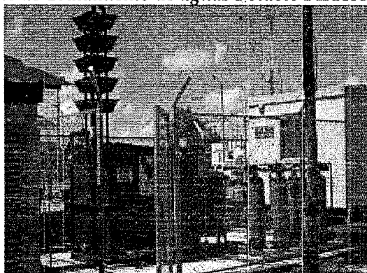
Foto 3. Plante de Tratamiento de aguas Potable PETRONORTE S.A.
