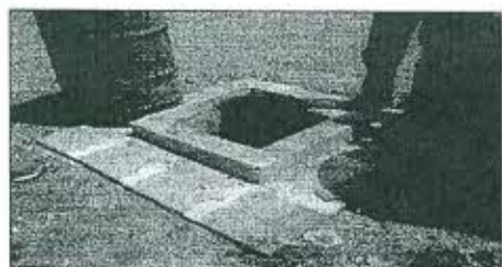
Foto 17. Caja de Registro.
